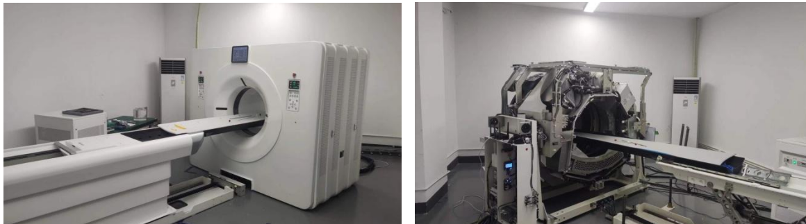
图4-1 生产楼一楼1#、2#PET/CT调试机房PET/CT
