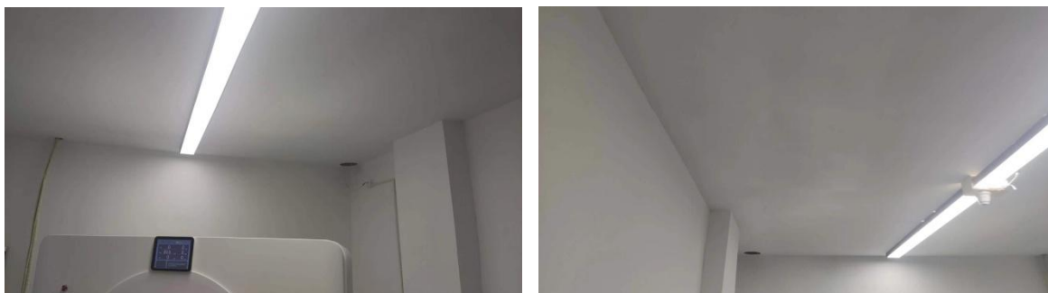
图4-3 生产楼一楼1#、2#PET/CT调试机房通风口
